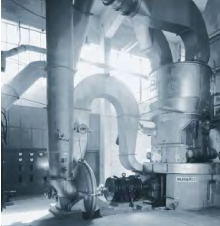
Loeschemühle I mit 100 kW Siemens-Schuckert-Motor.
